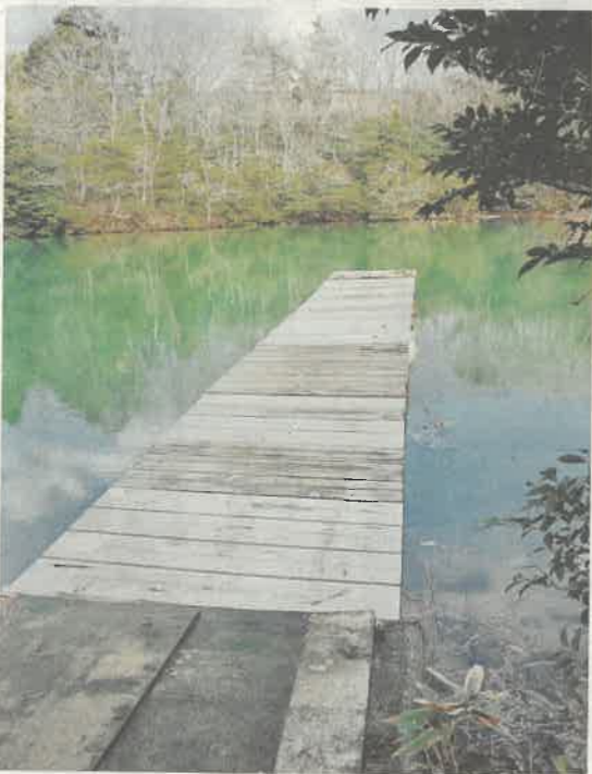
池にある棧橋。老朽化で傾きや木材の腐食が目立ち、危険な状態となっている
